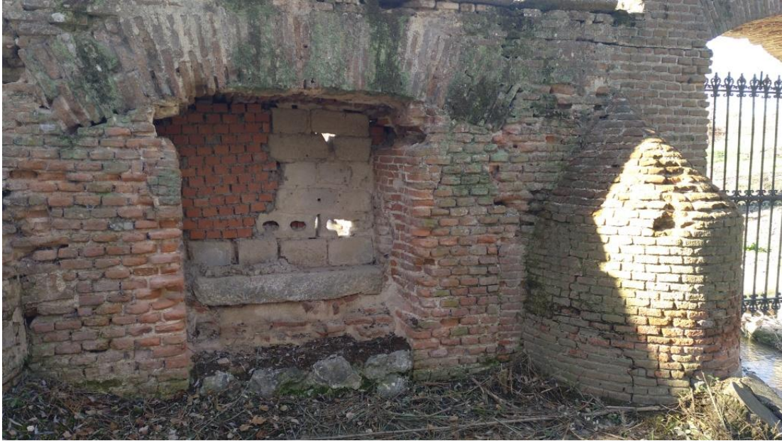
Tapado de una de las salidas antes de su restauración, y el abandono que se puede visualizar en el talado de dos arboles crecidos en su contrafuerte en el que había generado una grieta
