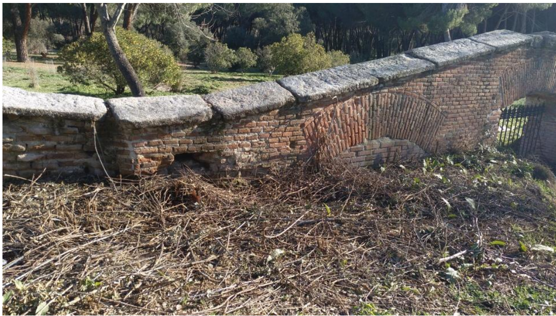
Vista del arroyo del Portugués, antes de su restauración, desde el parque de Somosaguas, con acumulación de arenas y maleza de más de un metro y medio
